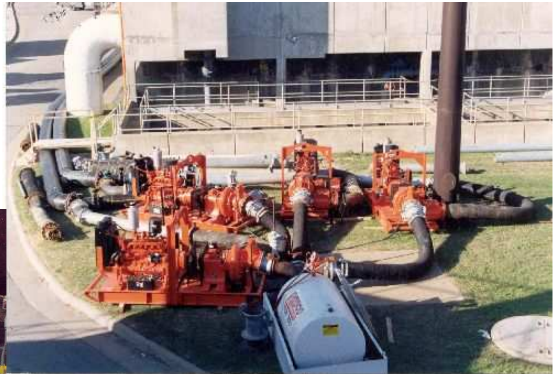
DPC300: Desvío en torre de enfriamiento en Refinería
