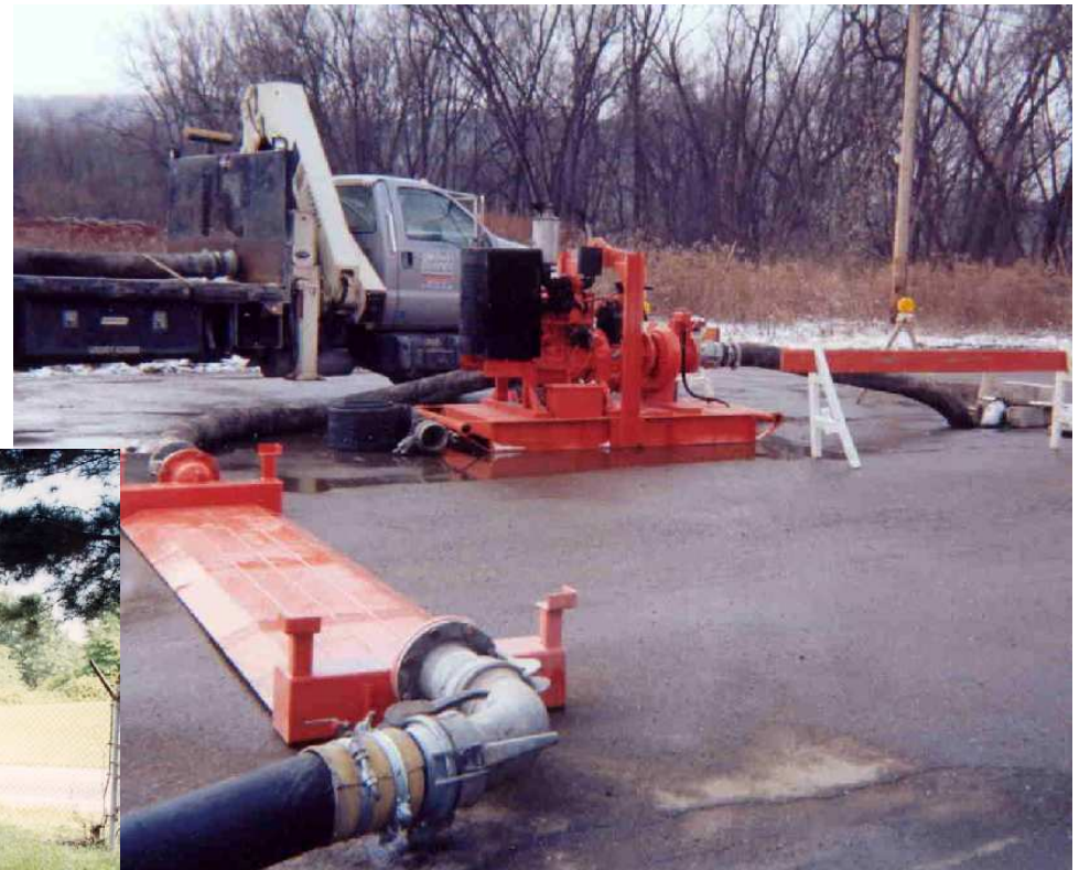
CD225: Desvío de aguas negras con rampa de camino
