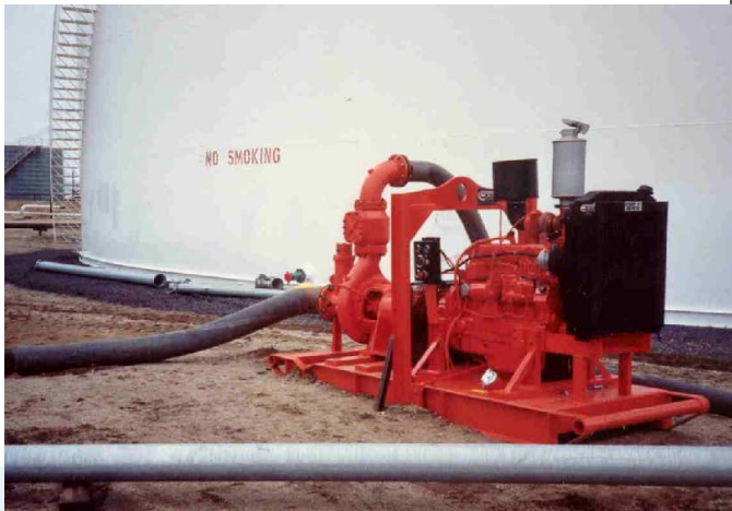
HL200 Bombeo/transferencia de producto en Refineria
