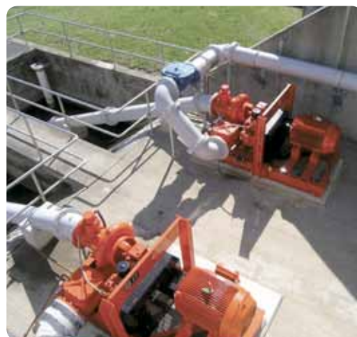
Bombas Dri-Prime con accionamiento eléctrico en instalación permanente impulsando el efluente de un filtro percolador secundario a una cámara de cloración y descarga posterior.
